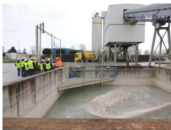
Récupération et traitement des eaux de lavage
