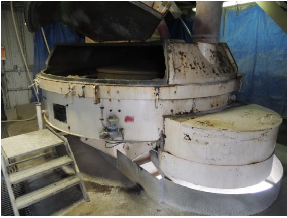
Le malaxeur à béton
